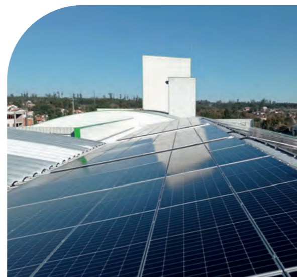
Une unité de production de 362 panneaux photovoltaïques de 550 Wp chacun a été installée sur le site de Santa Comba Dão au Portugal.
